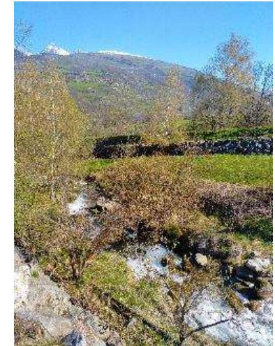
Digue du torrent du Bonnegarde à la Plagne-Tarentaise /Aime-la-Plagne
