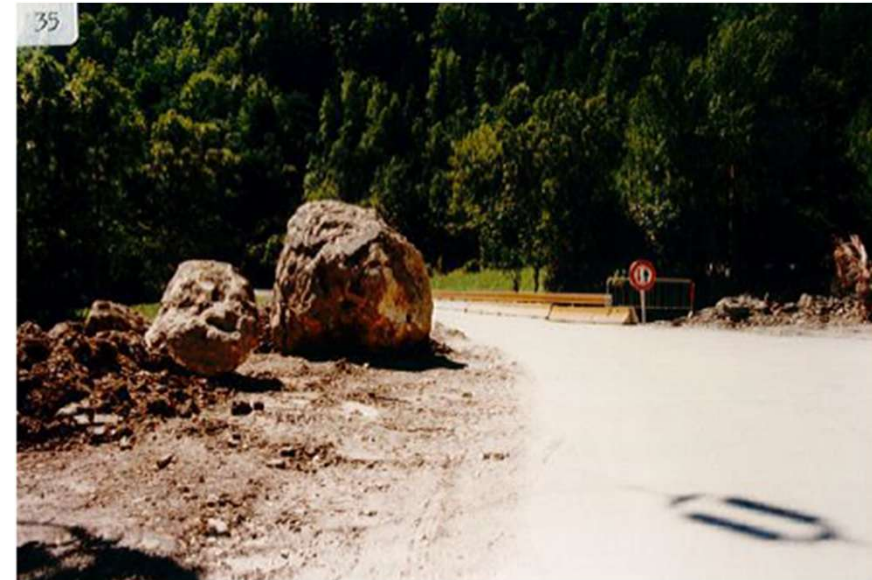
Crue de l'Arbonne 1996 Bloc déposé sur le tablier du pont Source : ONF
