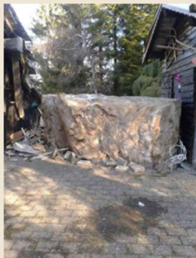
Chute de bloc à Morzine en 2013 Photo ONF-RTM 74
