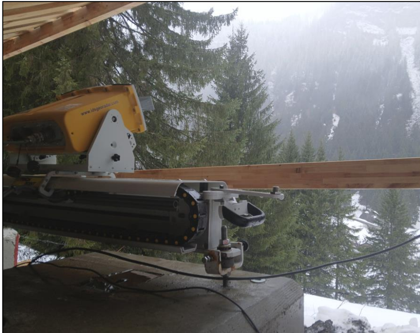
Dispositif de surveillance par radar interférométrique IBIS-FM
