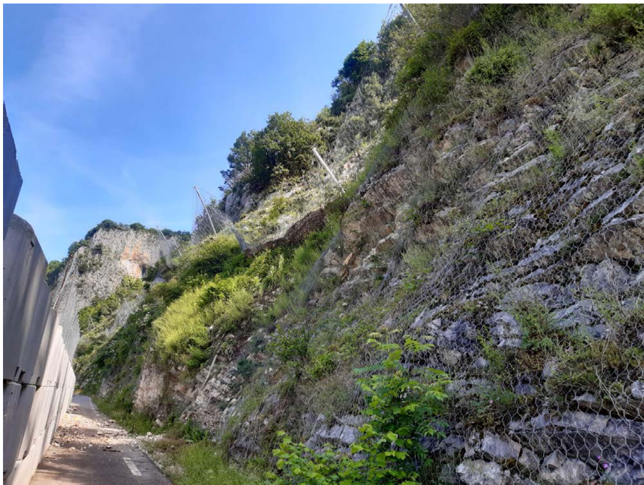
Figure 5a : Couloir éboulement 2023 (©Cerema)
