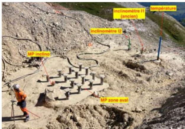
Fondations sur pieux verticaux de la gare amont du télésiège du Marais (Tignes) et dispositif de suivi topographique, inclinométrique et thermique.
