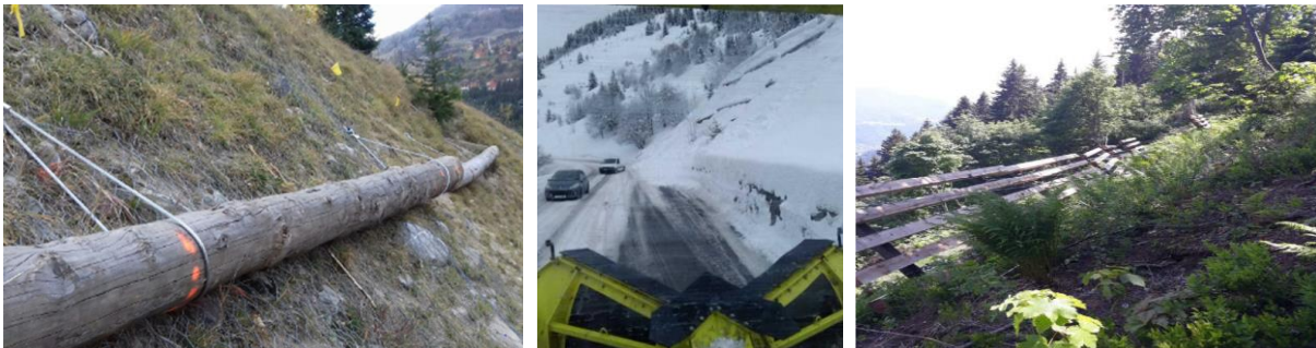
Stabilisation du manteau neigeux par grumes anti-reptation à Bourg-Saint-Maurice (RD 119) et par claies (à droite)
