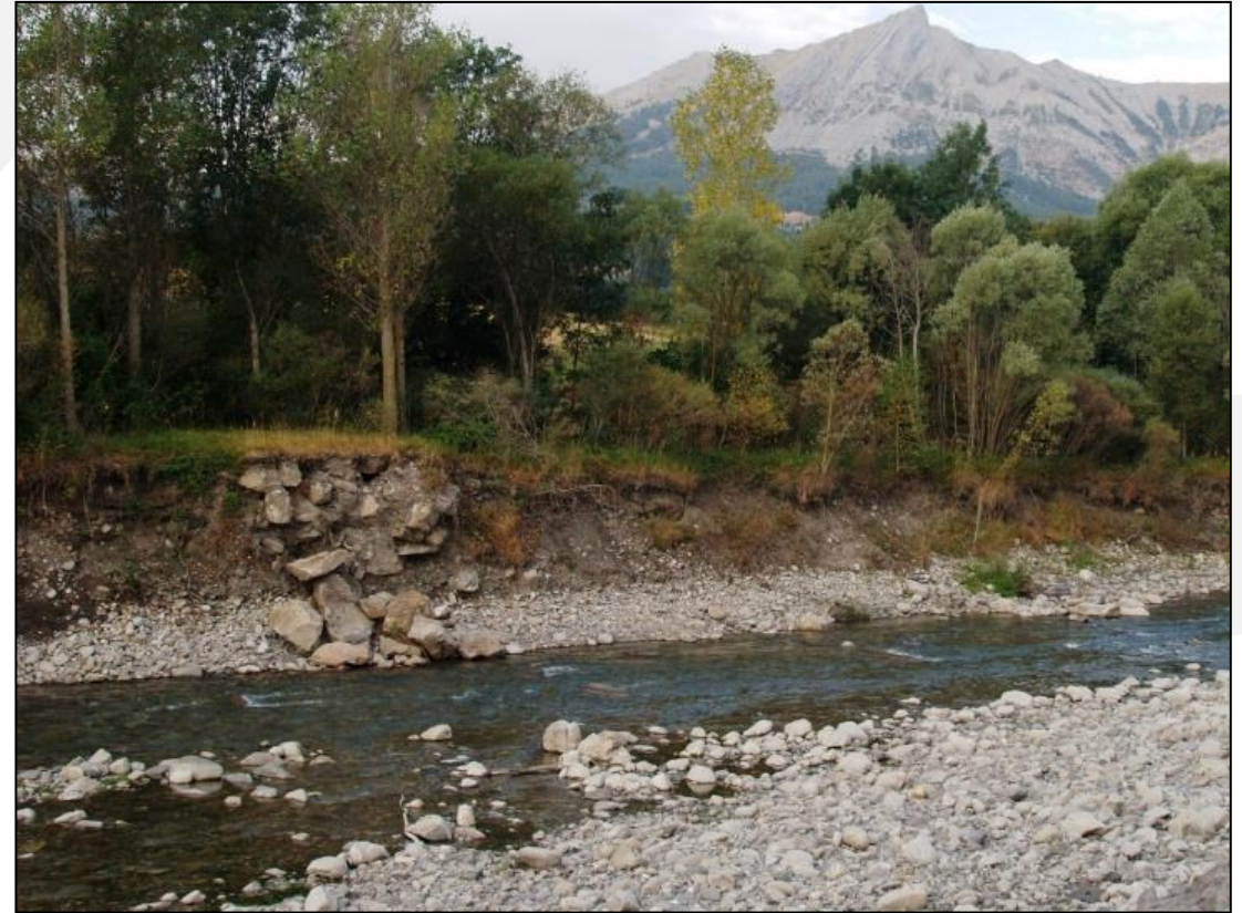
Digue et protections de berge du plan d'eau affouillées
