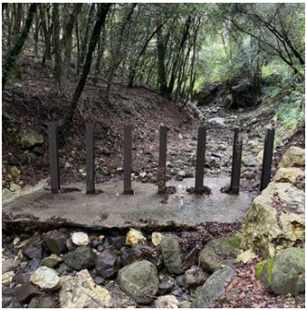
Peigne à embâcles en amont des Combes (Biot)
