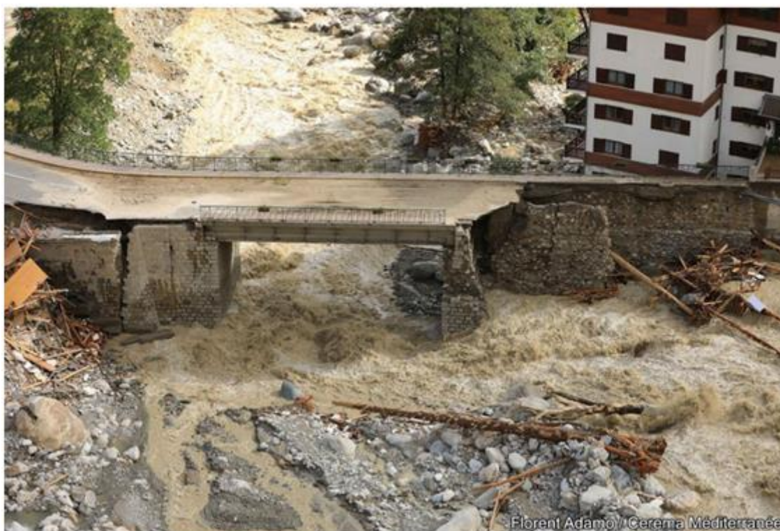
Photo 1 : Vue amont du pont de Venanson sur la commune de Saint-Martin-Vésubie (Queffelec et al., 2022). Le pont endommagé ne permet plus de relier le centre de la commune aux quartiers périphériques. Celui-ci sera démantelé le 22 octobre 2021.
