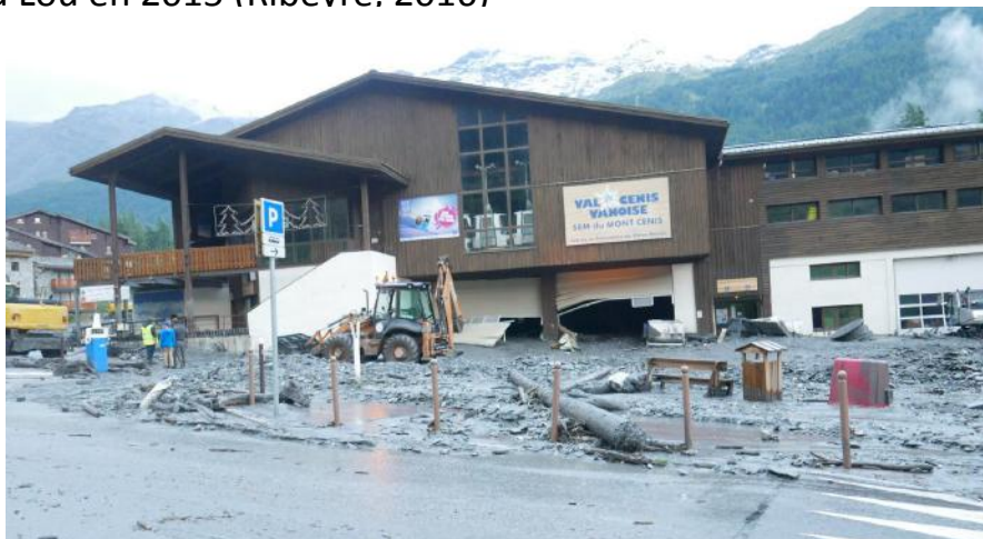
Les dégâts sur la SEM de Val Cenis (Le Dauphiné Libéré, 25/08/15)
