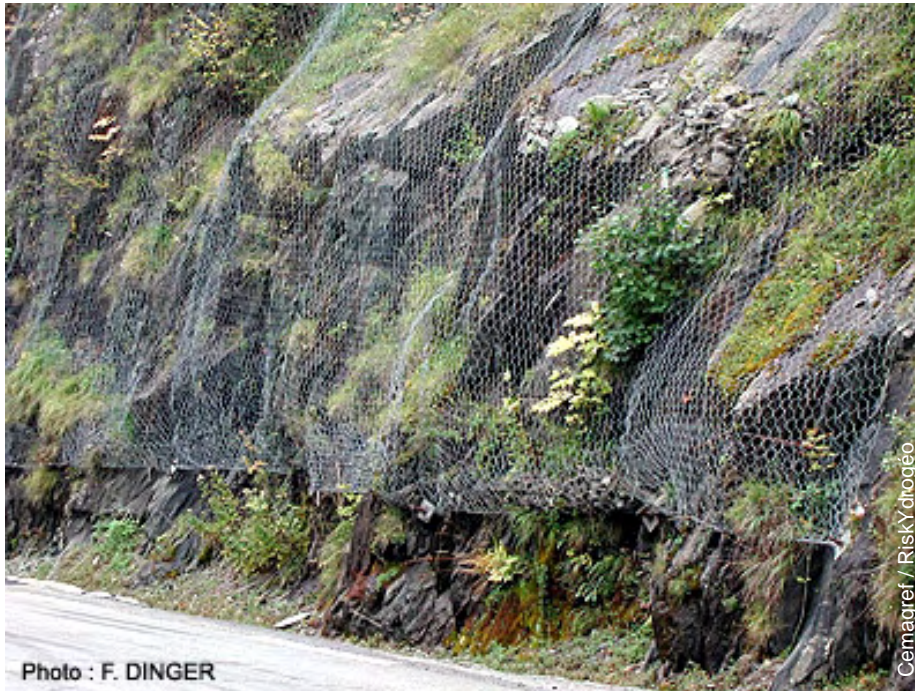
Talus revégétalisé et protégé par un grillage
