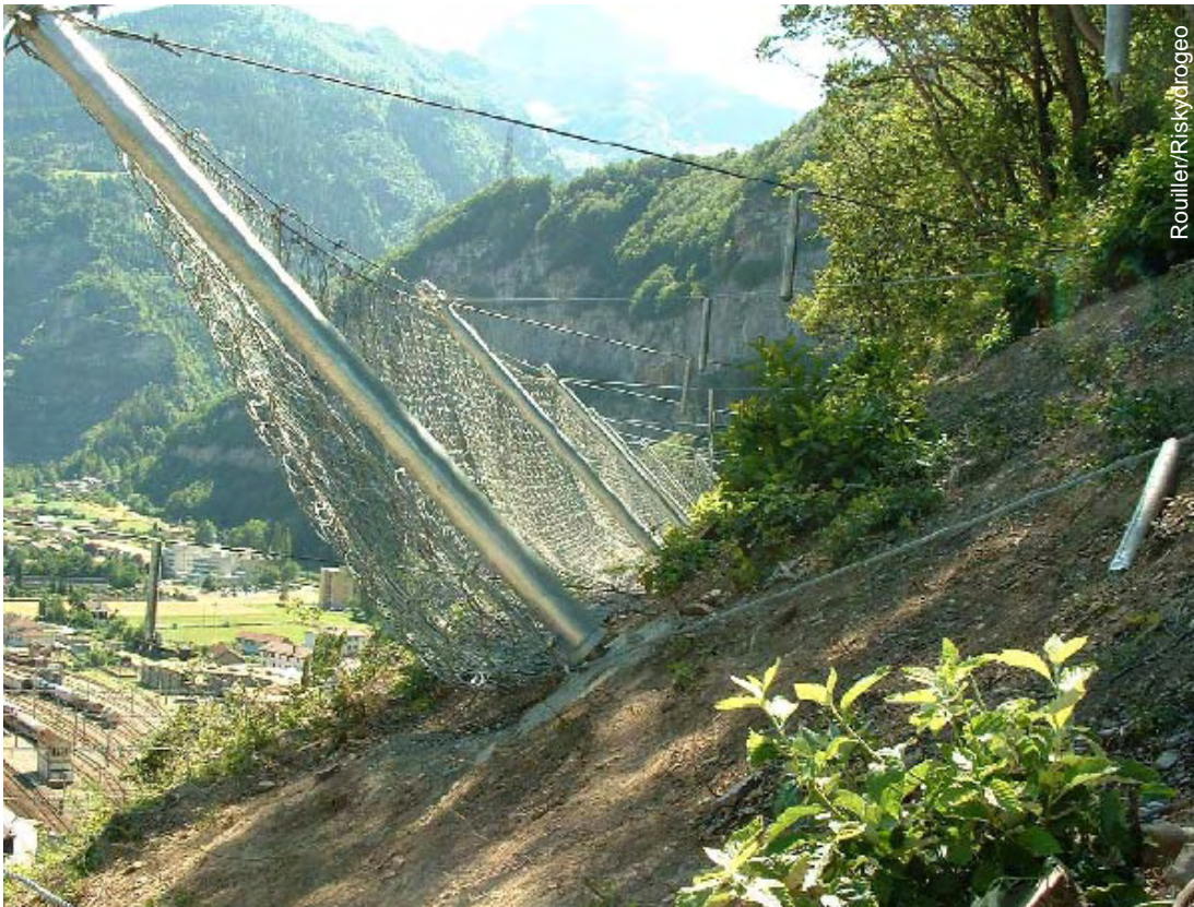
Ecran pare-pierres à haute énergie (1500 kJ) déformable, Saint-Maurice (Valais)
