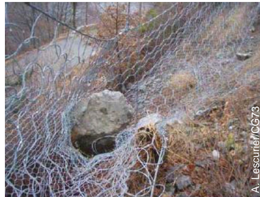
Chutes de blocs
