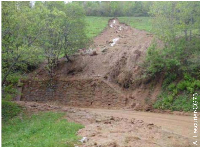
Glissement superficiel le long de la RD213, accès au col de la Madeleine, Mai 2010
