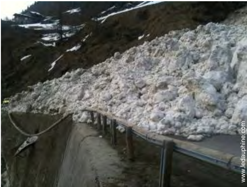
Route de Tignes et Val d'Isère coupée par une avalanche, Avril 2013
