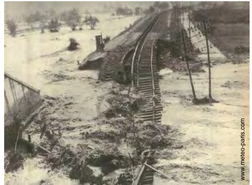
Inondations catastrophiques : Queyras, Maurienne, Ubaye, Juin 1957
