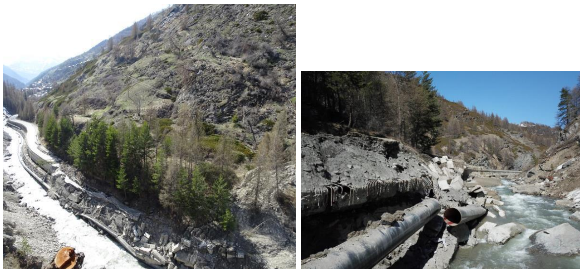
Figure 33 : Le 8 avril 2018, destruction du mur de soutènement (à gauche) & destruction de la conduite de la centrale hydro-électrique (à droite)
