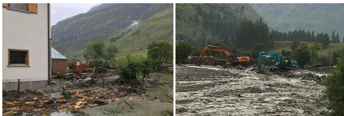
Figure 24 : Coulée de boue et lave torrentielle à Bessans (73).
