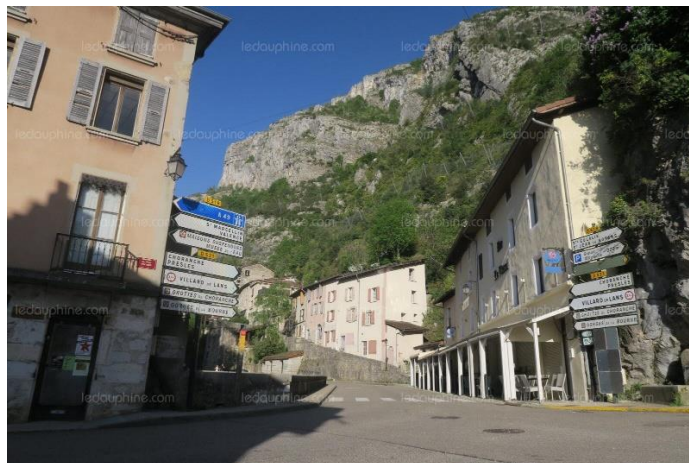
Figure 31 : Chutes de blocs à Pont-en-Royans (38).
