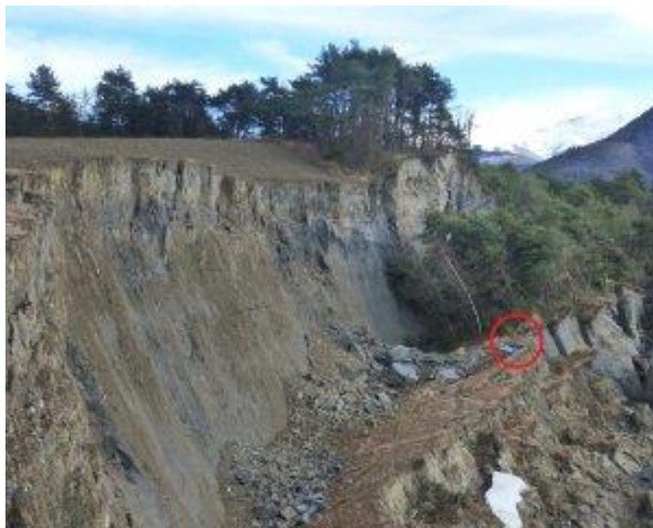
Figure 8 : Glissement de l'Harmalière après sa réactivation en janvier 2017. Source : Mickael Langlais, ISTERre.
