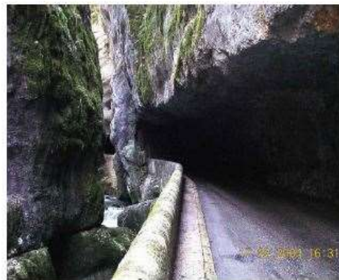
Eboulement de 2005 entre les tunnels 7 et 8 - avant -
