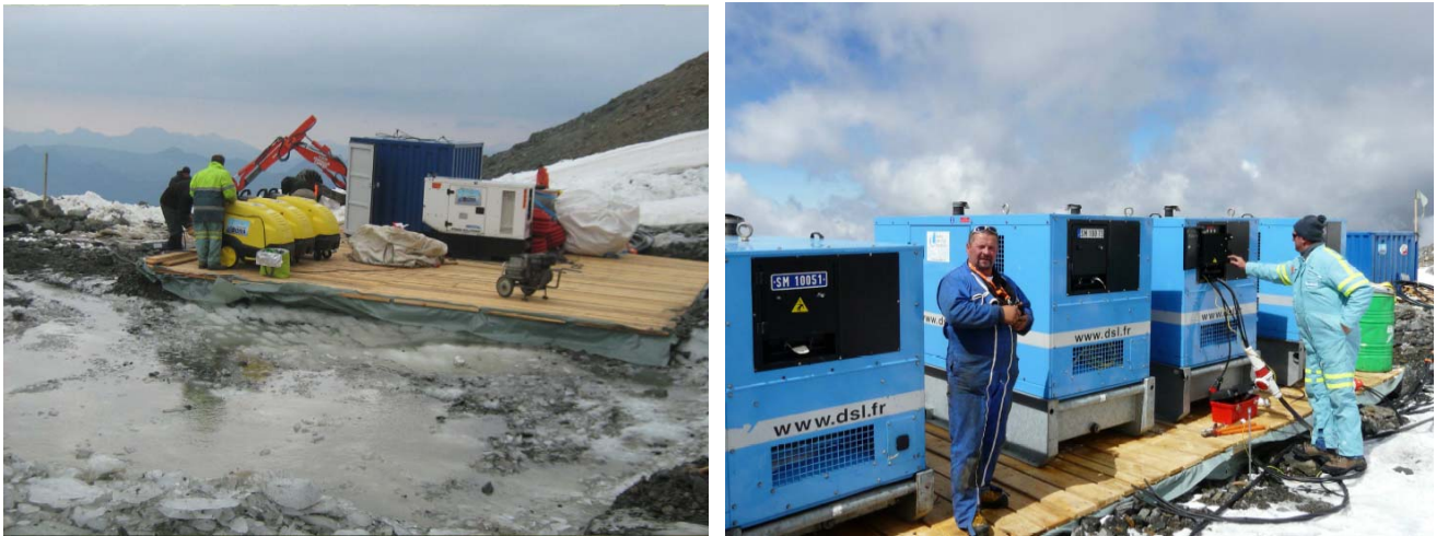
Fig. 18. Plateforme pour les groupes électrogènes
