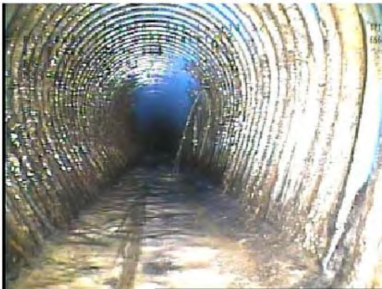
Figure II.18 : Photographie de la calcification des crépines de la tranchée 3
