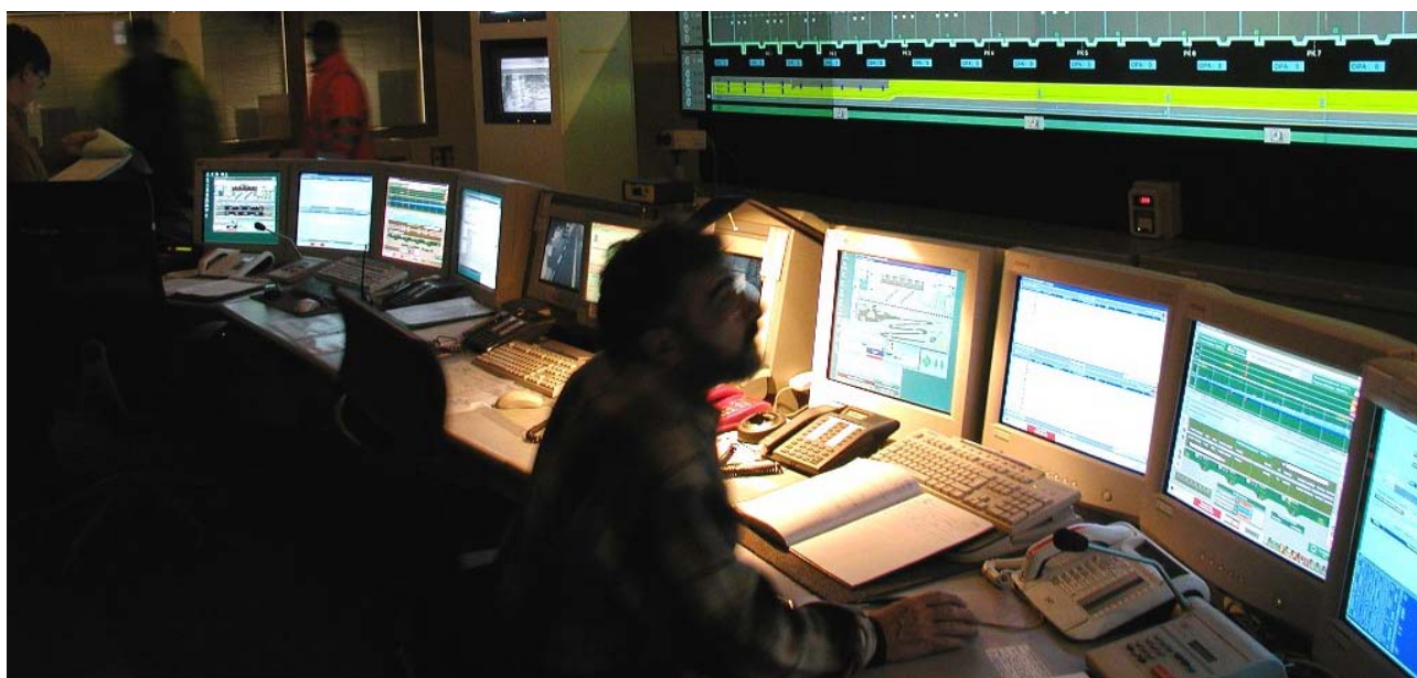
Figure 5 : PC sécurité du Tunnel du Mont-Blanc (photo R. Bolognesi).
