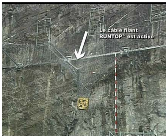
Activation des câbles filants
