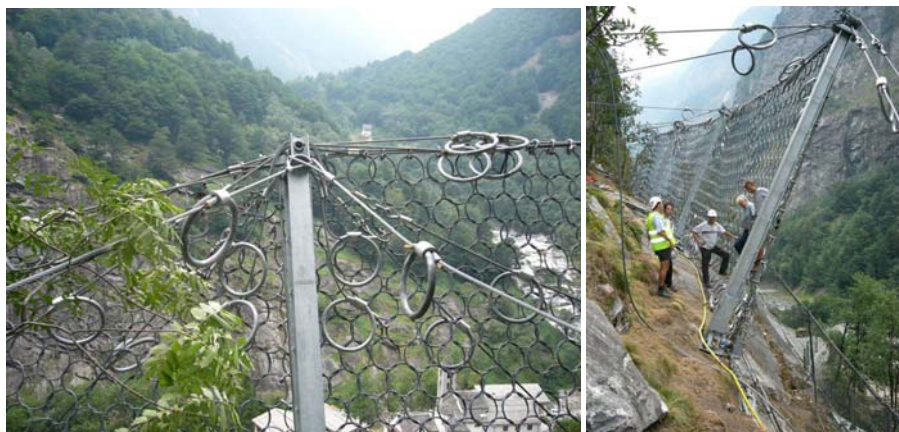
Système de freins et ancrages amont des filets Geobrugg 3000 kJ
