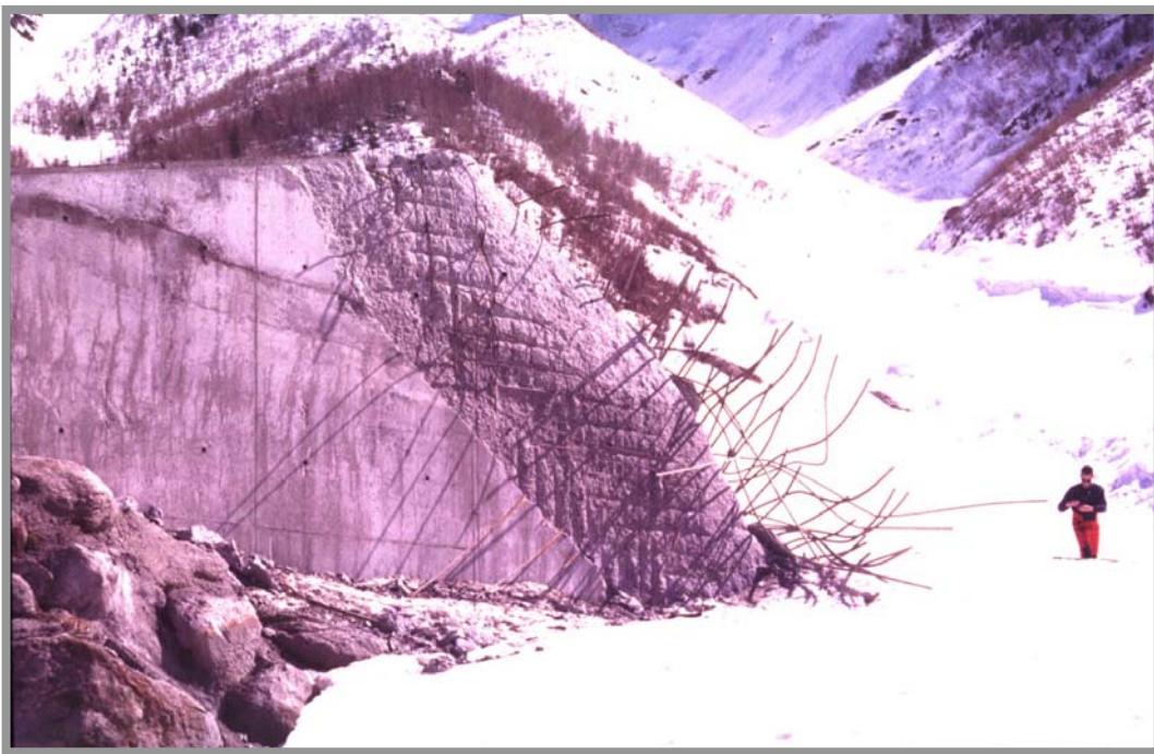
Une des dents endommagées de Taconnaz – Photo Cemagref
