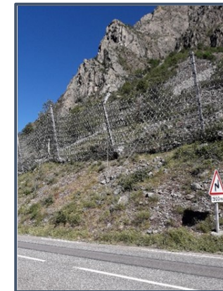
Filet pare-bloc : La Grave Source : ONF-RTM
