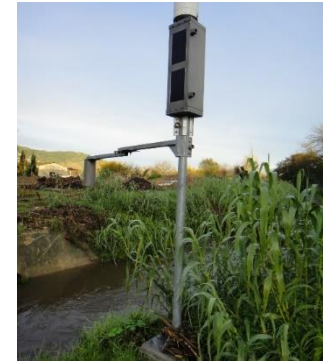
Ex. de station nouvelle génération : radar + pluviométrique à impact
