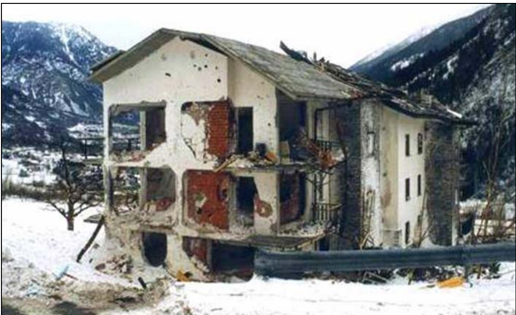
Sito valanghivo a Elevato RISCHIO - Valori presenti IMPORTANTI – Dailley – Morgex - Foto Ceriani
